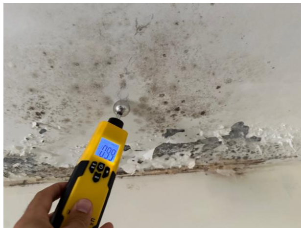
Taux d'humidité de 99% au plafond de la cuisine (Présence d'humidité)
